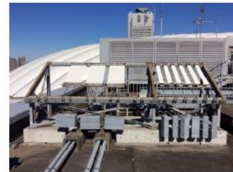
暴露状況写真
