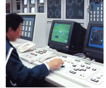
防災センター
