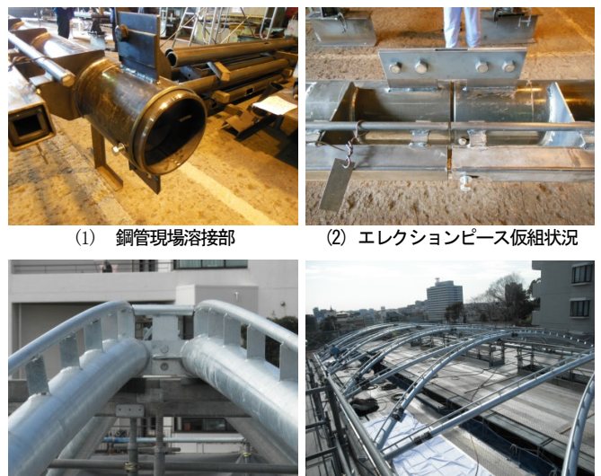
(1) 鋼管現場溶接部 (2) エレクションピース仮組状況 (3) クロスアーチ中央接合部 (4) クロスアーチ全景
