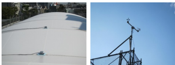
写真6 加速度センサー、風向風速計設置状況
